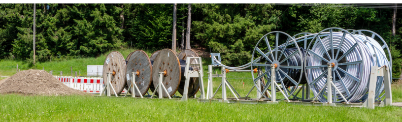
Leerrohre am Straßenrand bei St. Johannisrain
