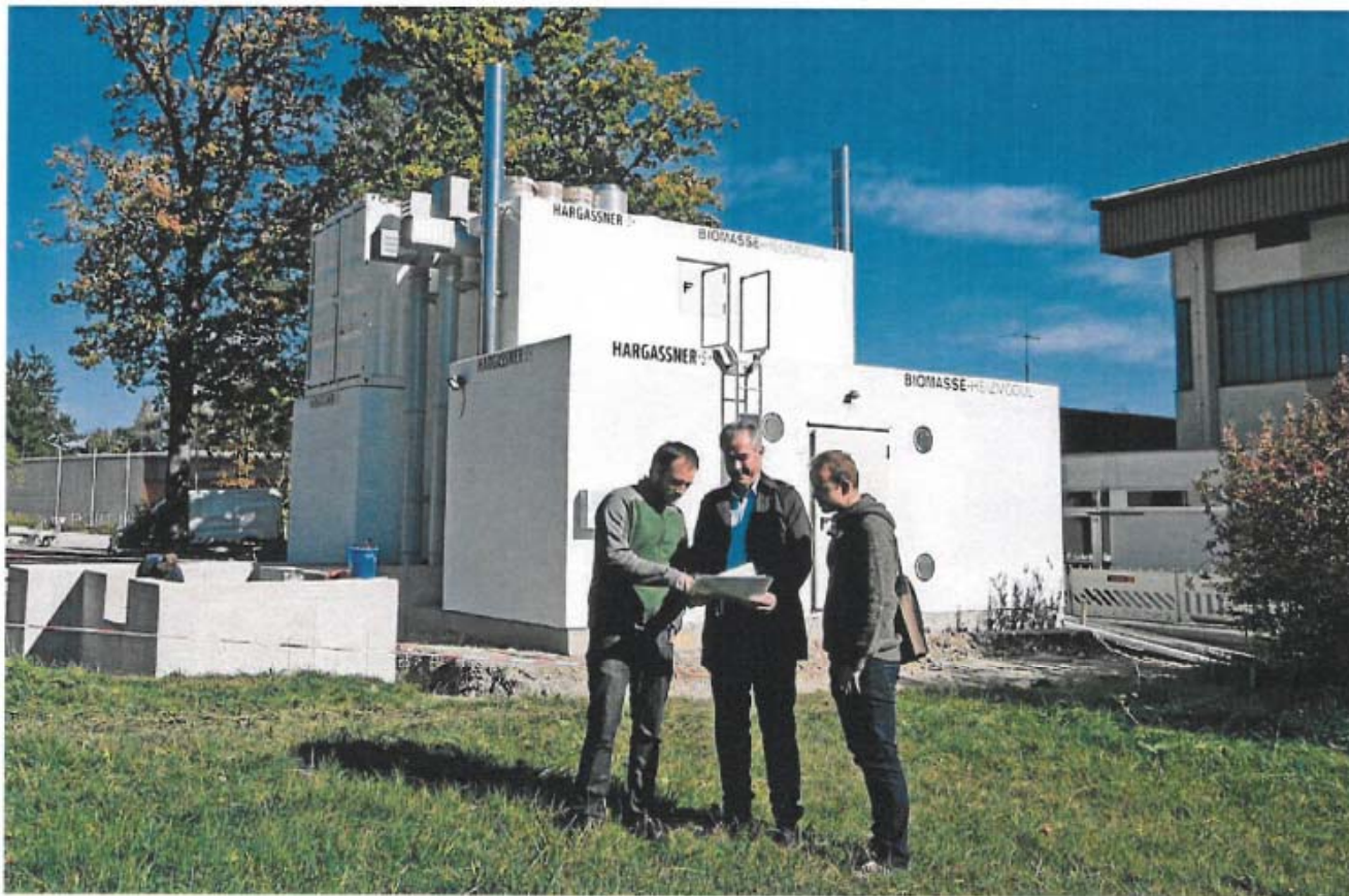
Bald in Betrieb: das neue Heizwerk neben der alten Wellenbad-Turnhalle (rechts); im Bild von links Planer Ben Ludwig vom Ingenieurbüro Sendl, Stadtwerke-Vorstand Josef Vilgertshofer und Klimaschutzbeauftragter Patrick Jähnichen. Hier nicht zu sehen ist der hohe Turm auf der Rückseite: ein Pufferspeicher, der fast 12 000 Liter Wasser fasst. FOTO: WOS
